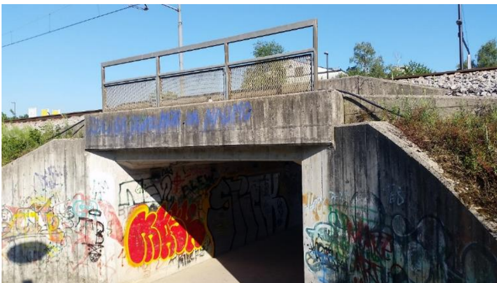
Pogled na robni venec na desni strani proge, ki ga je potrebno razširiti za 25 cm, da se bo nanj lahko namestila nova PHO. Obstoječa ograja se odstrani.
